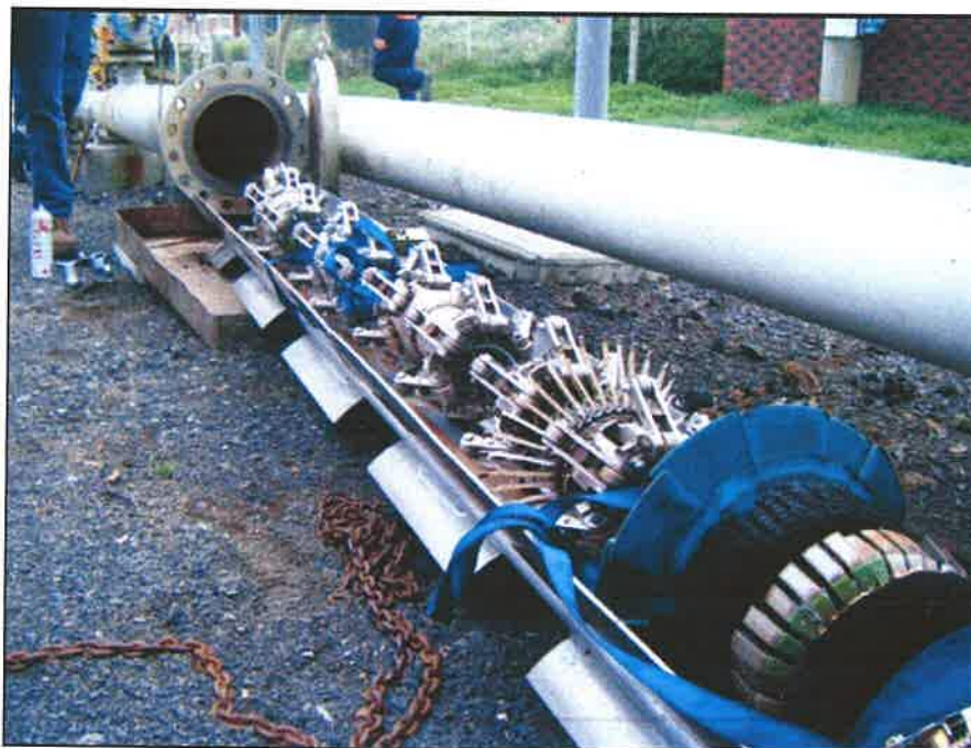
Imagine 1 Dispozitiv inspecție și curățare (Godevil)
