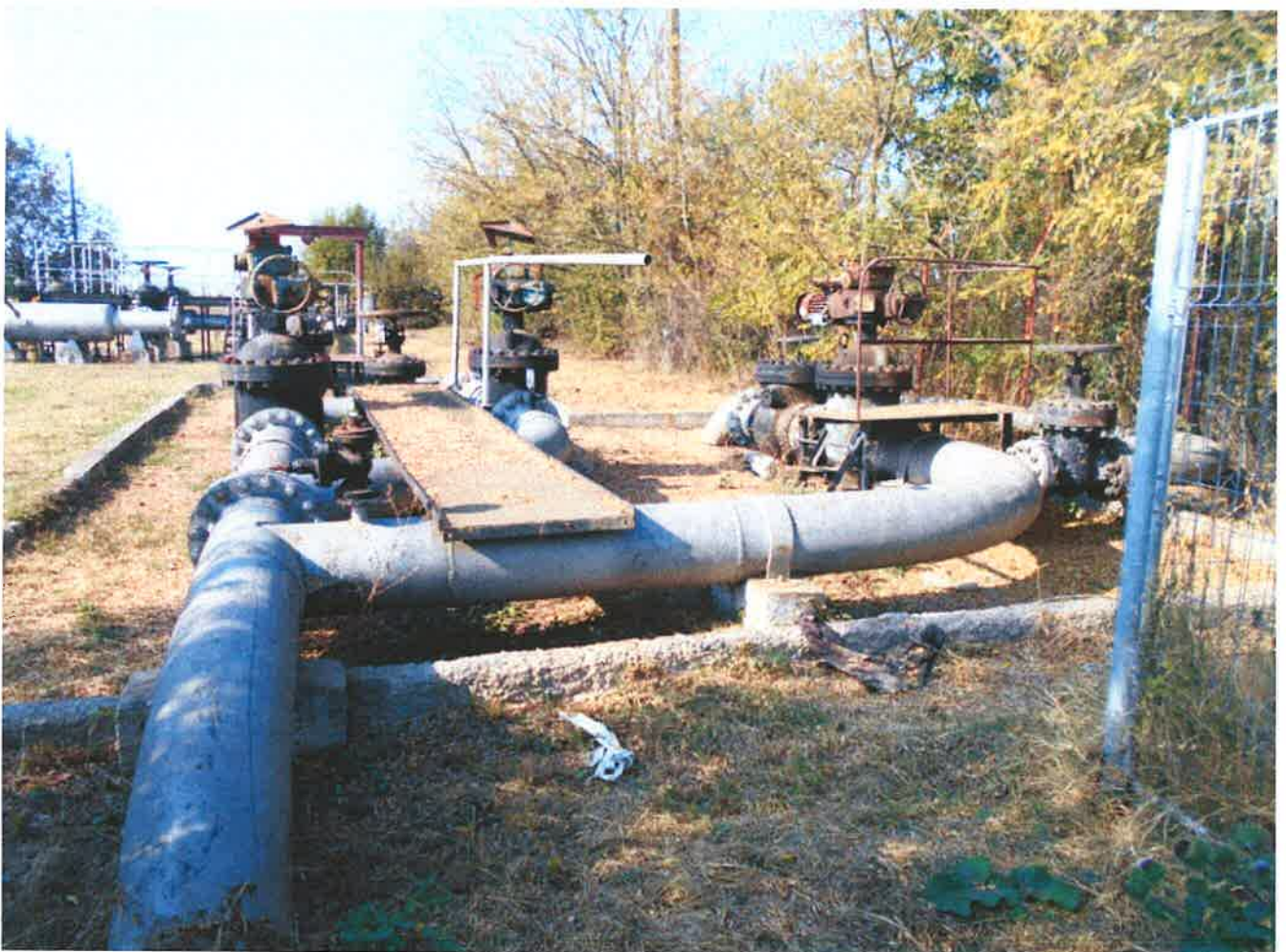
Imagine 8 Tronson 6- Intravilan UAT Dragos Voda - Statie pompare Conpet SA
