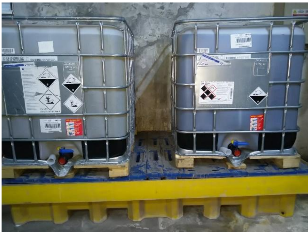
Referinta 25: Stocarea substantelor chimice in containere IBC pe cuve de retentie in zona de productie
