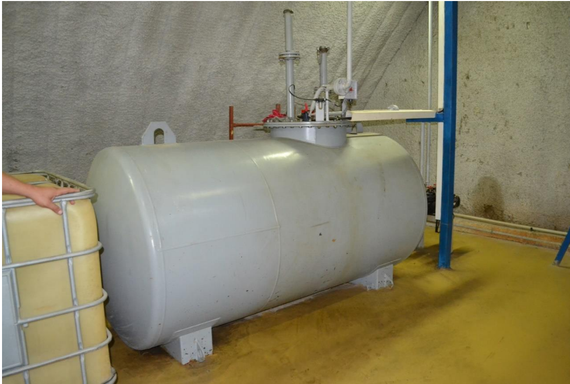
Figura nr. 2-6 Rezervor motorină Hală PAX
