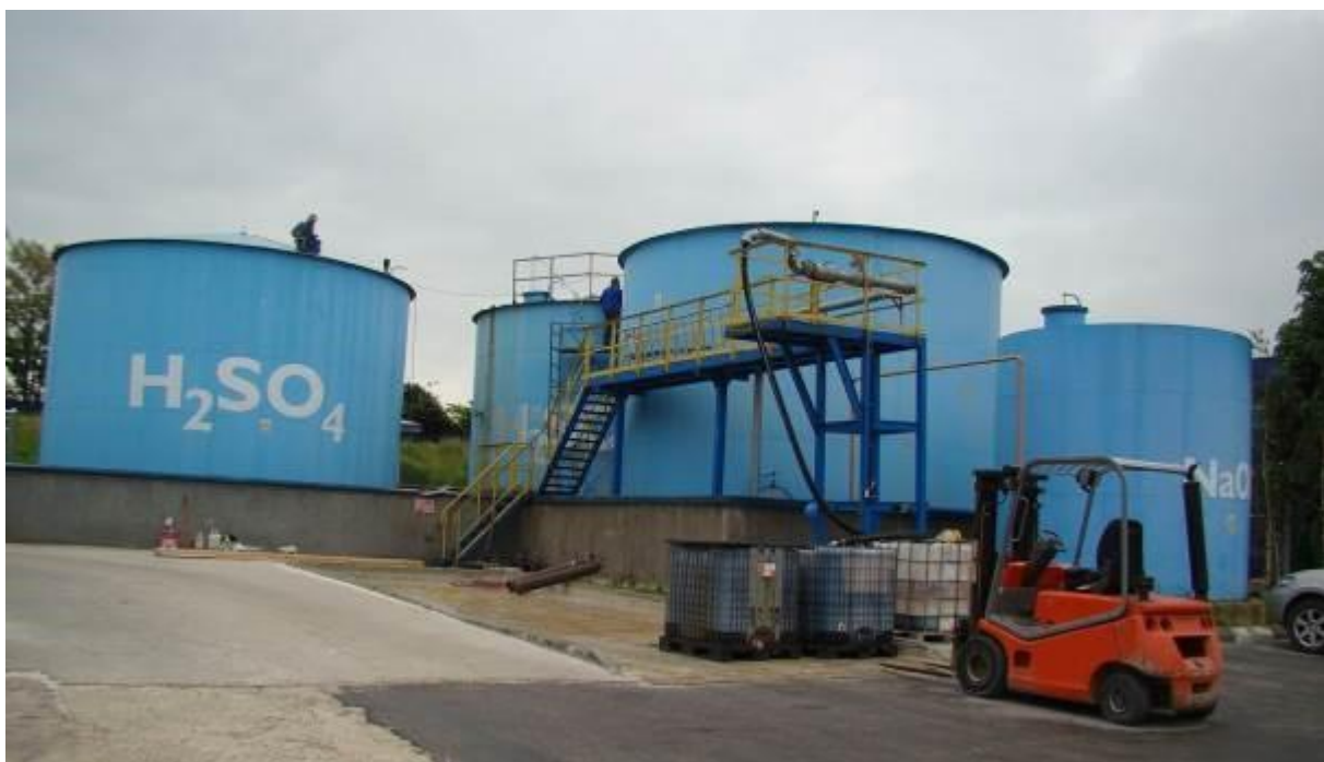
Figura nr. 2-5 Rezervoare de H 2 SO 4 și de neutralizare cu NaOH
