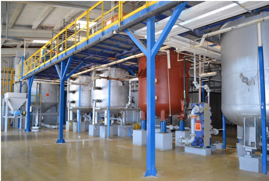
Figura nr. 2-13 Instalație producere PAX
